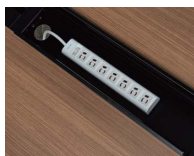
ケーブル格納スペース
