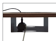
ケーブル格納スペース
